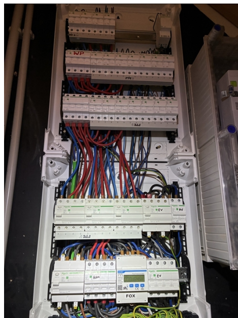
(Elektrisch bord - binnenkant)
